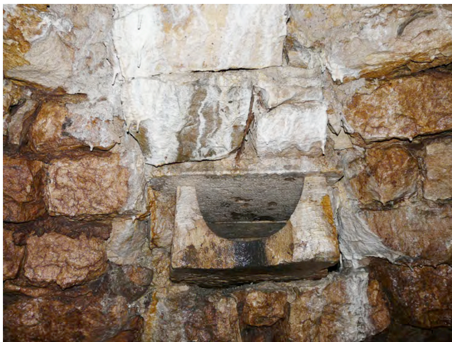
fig. 24 : Exutoire des canalisations C.5 et C.6 (angle N/O du cloître) © C. Travers – Archéoverde
