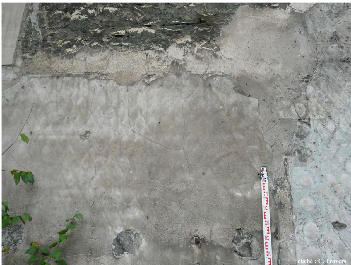
ill. 48c : Traces de treillage et bouchages sur le mur du fond de l'aile Ouest de la serre XIX e
