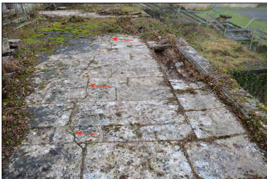
fig. 53 : Fissure au niveau de la terrasse (© C. Travers)
