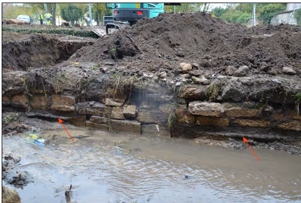
fig. 33 : Rebord de mortier observé à la base du mur du bassin actuel, reliquat d'un ancien enduit au ciment (© C. Travers)
