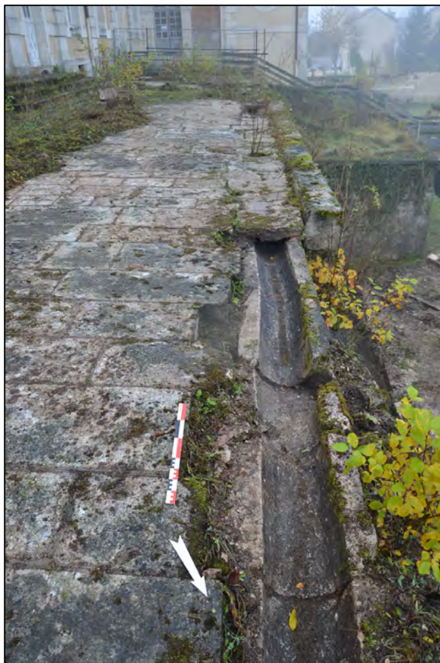
fig. 43 : Réseau de canalisations mis au jour sous les dalles de la terrasse pour l'évacuation des eaux de toiture, canalisation de rive (© C. Travers)
