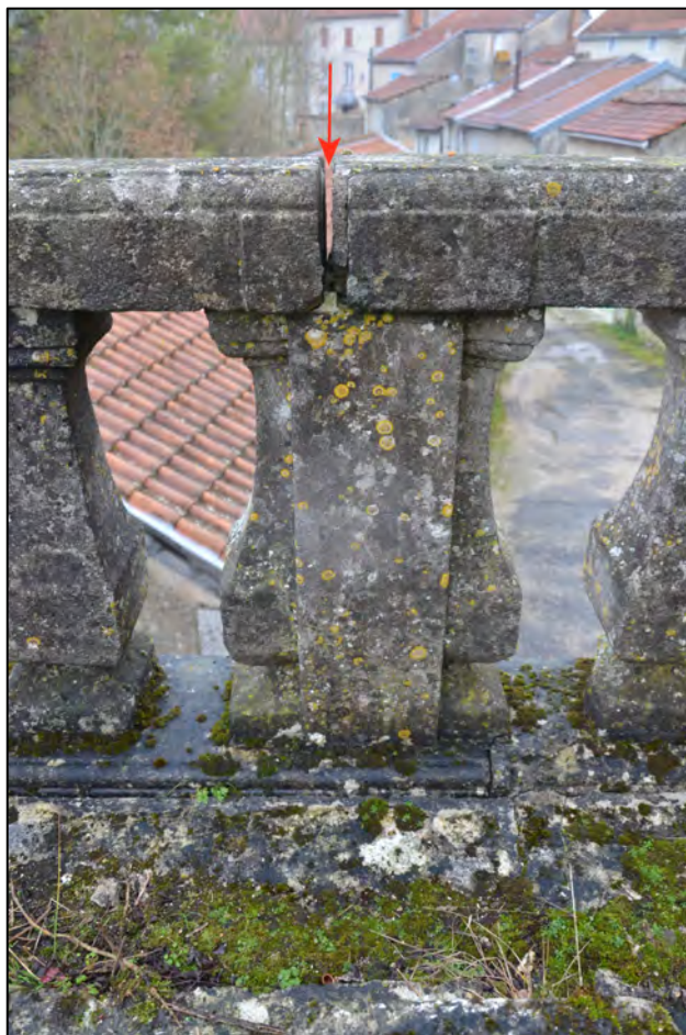
fig. 54 : Décrochement de la partie nord de la balustrade de la terrasse (© C. Travers)
