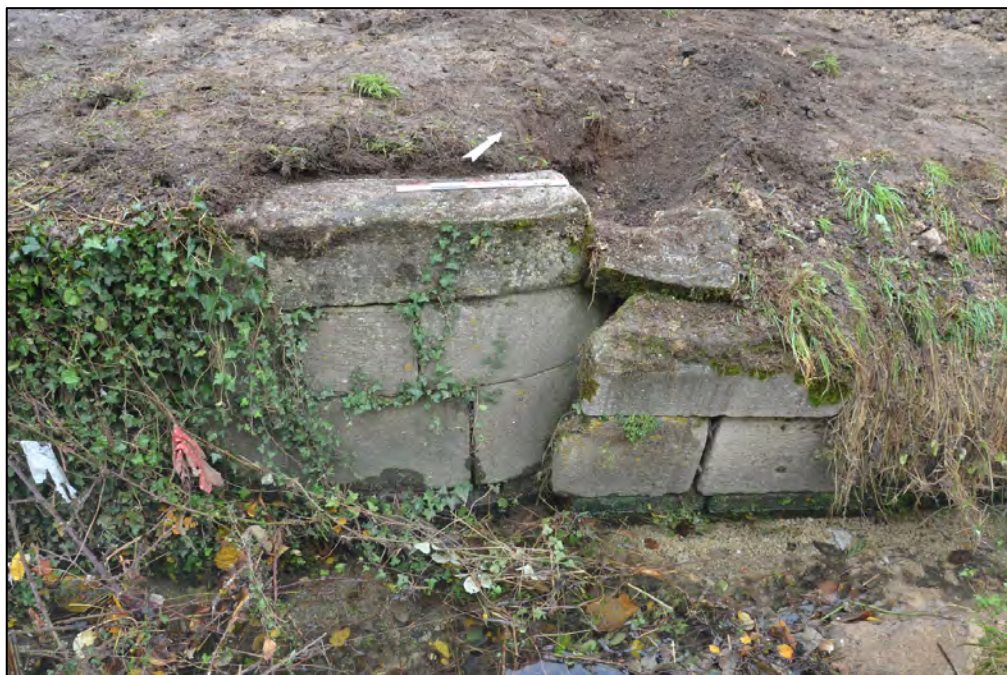
fig. 27 : Anomalie sur le parcours de M3 (© C. Travers)
