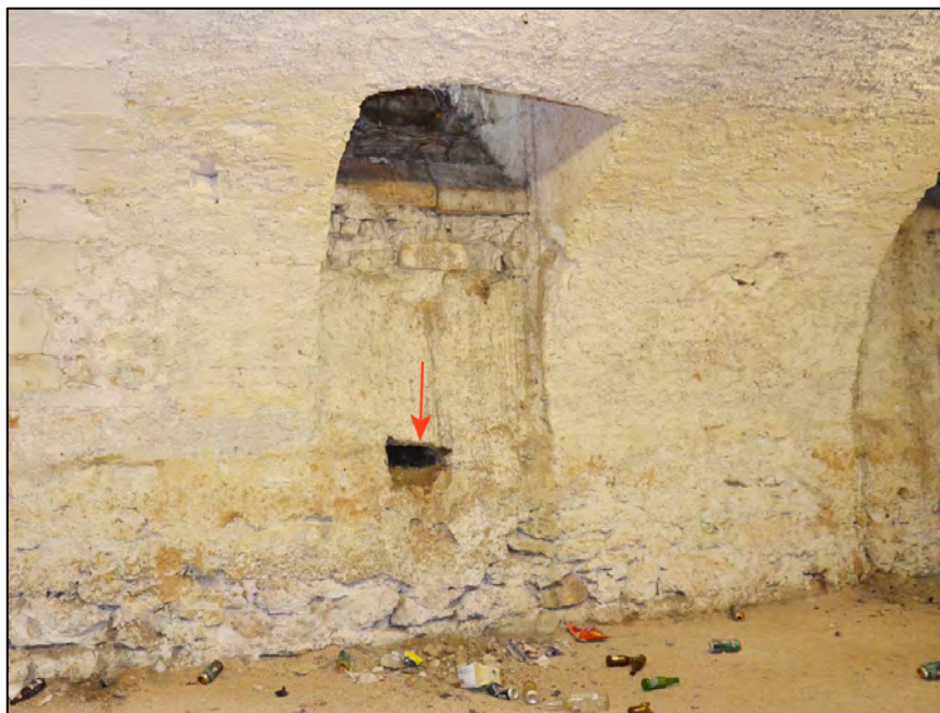
fig. 46 : Evacuation d'eau observée dans la pièce centrale des caves Nord (© C. Travers)
