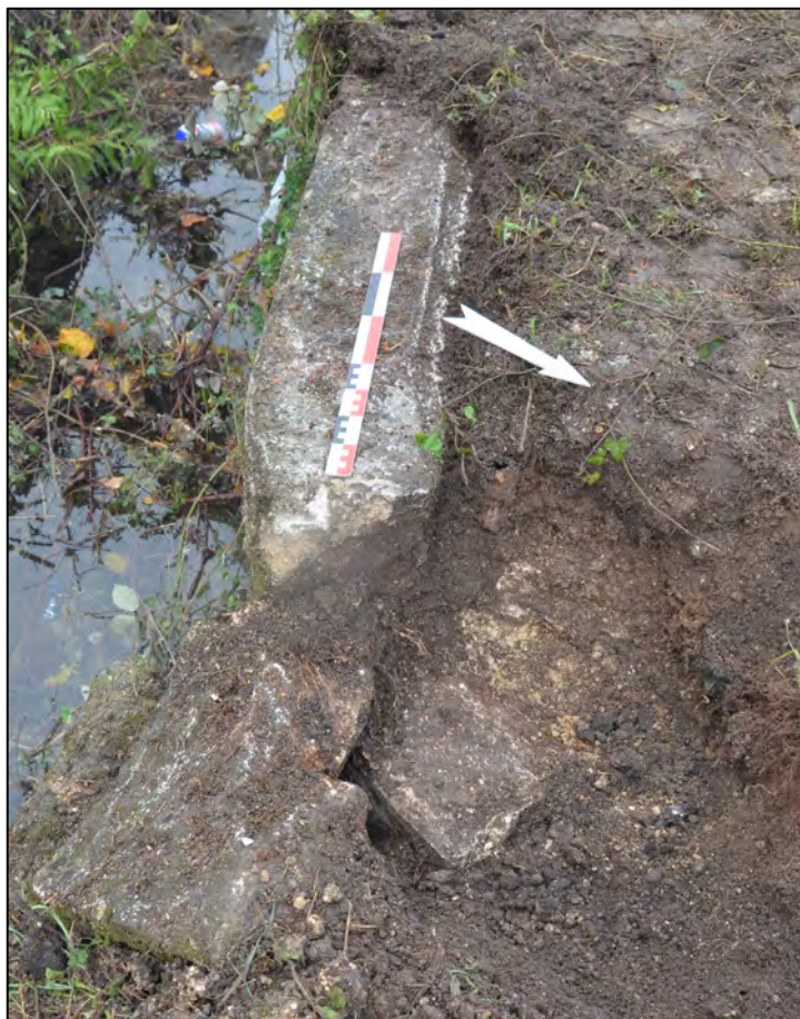
fig. 28 : Anomalie du parement de M3 vue de dessus (© C. Travers)
