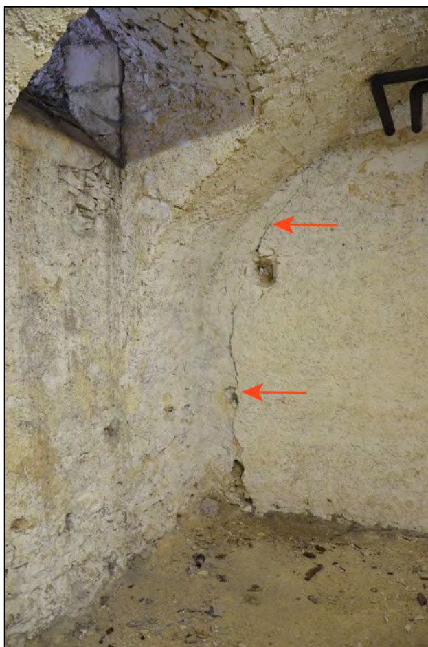
fig. 52 : Fissure à l'extrémité nord d'un mur de refend de la cave (© C. Travers)
